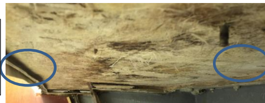
Figur 4 Allt fuktigt bortplockat.
