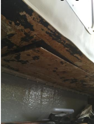
Figur 2 Första plattan som sågades bort, här var däcket riktigt svampigt och distansmaterialet av 100%vatten
